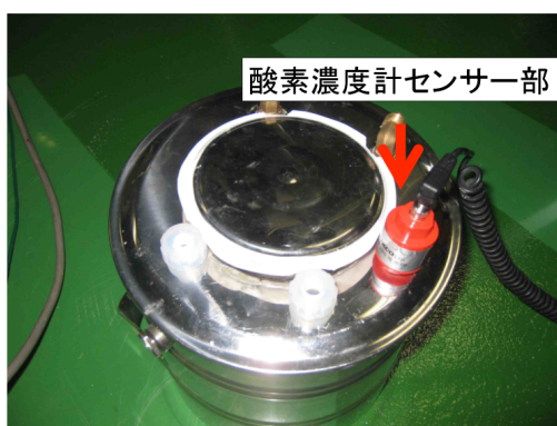
図 2.24: チムニー用気中酸素濃度計設置の様子 (蓋の検出器実装へ向けた試験の様子)
