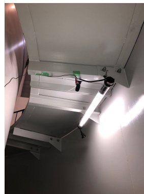
図 3.6: 防油堤天井に設置したカメラと電灯
