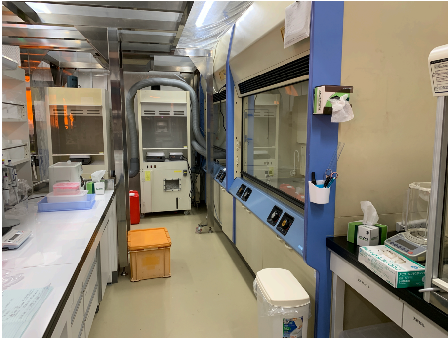
図 34: 筑波大学クリーンルームに設置されているドラフト (写真奥)
