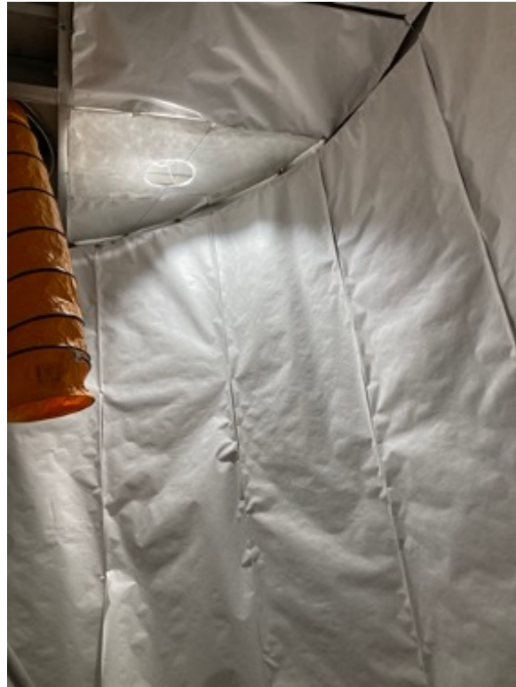
図 2.11: ステンレスタンク壁面に設置されたタイバックシート
