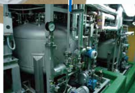
キセノン取扱い設備 [4]
