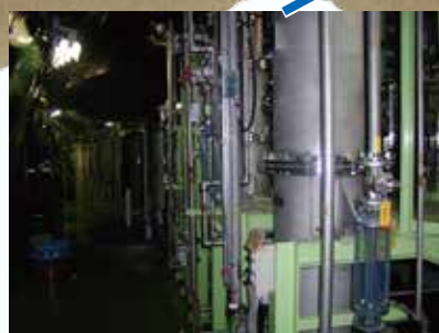
純水を用いた純化装置設備 [1]
